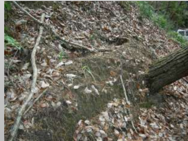
堤体土を大きくエグっている
